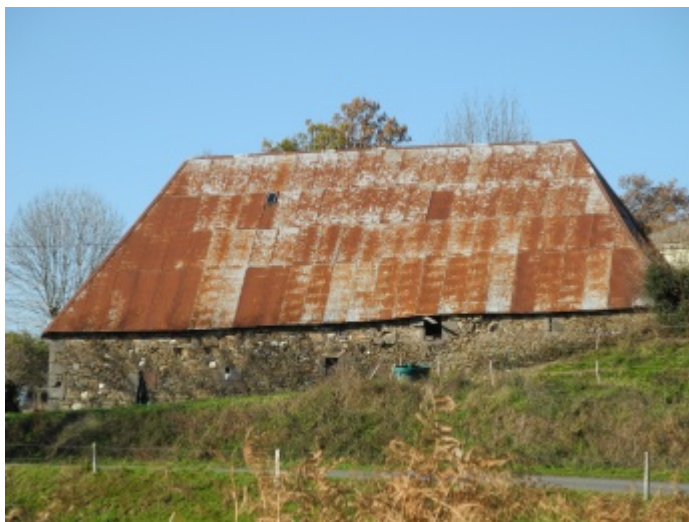
Grange de Bélières de Saint-Cernin datant de 1595, conservée en partie grâce à sa toiture en tôle.
