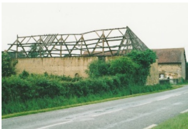
Grange-étable en bauge à Moitron (détruite). Photo Patrick Dejust - Maisons Paysannes de la Sarthe.
