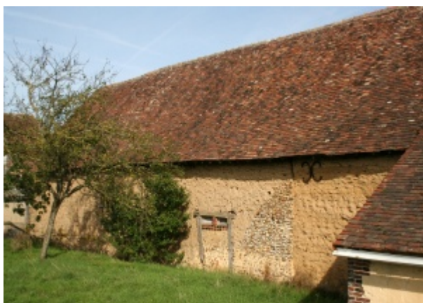
Préval, les Pâtis, façade arrière de la grange-étable en bauge avec renforts en rognons de silex. Photo Perche Sarthois, 2006.
