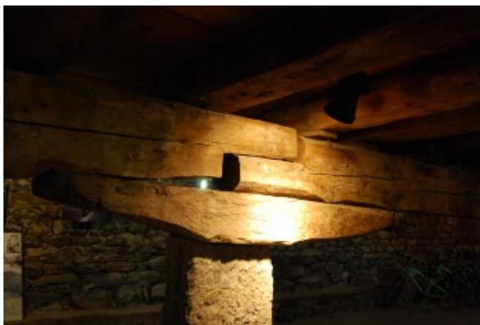
Photo d'un assemblage de liaison entre poutre centrale (charreyre) et poteau. La poutre est simplement posée.
