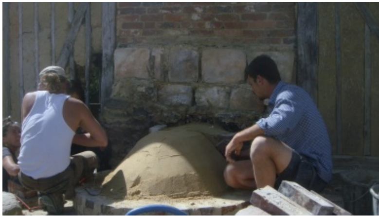
Coffrage pour réaliser la voûte du four à pain. Il est constitué de terre argileuse qui sera retirée après la pose de la voûte.
