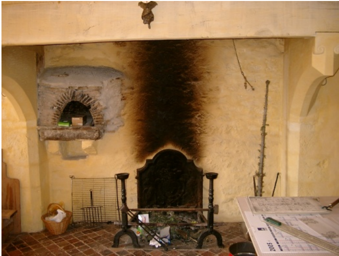
Vue intérieure du petit four compris dans la cheminée de la Porte Guiller XIII à Semur-en-Auxois (21). Photo André Mercuzot © Maisons Paysannes de France, Délégation de Côte-d'Or.
