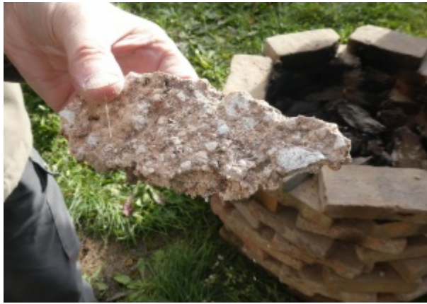
Morceau de griya ancienne détachée d'un mur.
