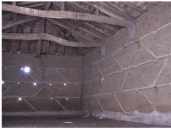
A l'intérieur d'une grange. Succession des banchées croisées alternativement dans un sens et dans l'autre avec un raccordement un biais de 45° et liaison par cordon de chaux. © Photo P. Forissier
