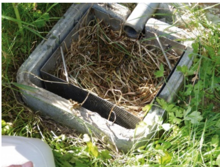
Filtre rempli de foin, recueillant la graisse avant la circulation des eaux usées dans les bassins plantés.
