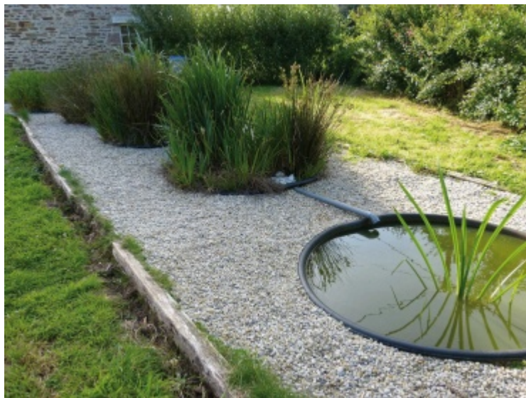
Bassins de phytoépuration pour eaux grises.
