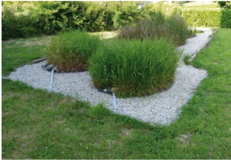
Les deux premiers bassins de prétraitement plantés de roseaux récupérant les eaux grises alternativement.
