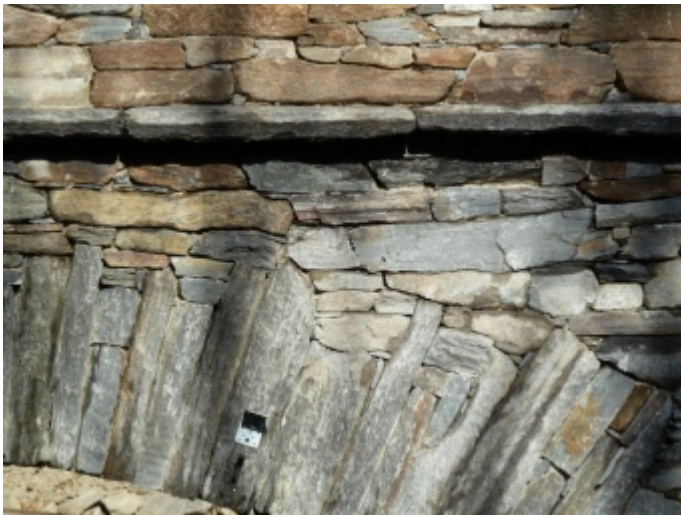
Cible fixée sur les blocs de pierre d'un bandeau afin de faire la mesure topométrique.
