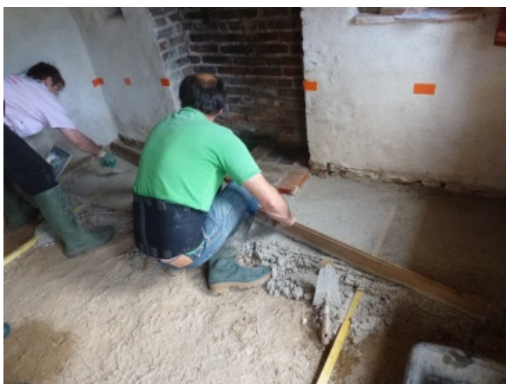
Tirage de la chape. Les tasseaux seront ensuite glissés pour continuer la répartition de la chape. Au mur, des morceaux d'adhésif servent de référence de niveau.
