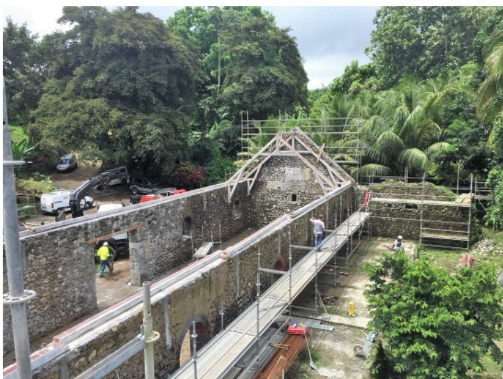
Pose d'une nouvelle charpente sur la halle principale de la purgerie. Photo Maisons Paysannes de France, Prix René Fontaine ©
