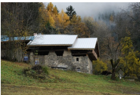
Toit après la pose du sarking. Photo P. et A. Hoogewys © Prix René Fontaine, Catégorie bâti contemporain, 2015.
