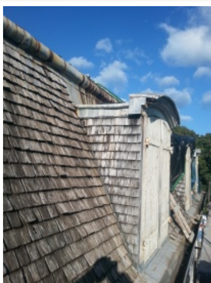
Toit couvert de bardeaux de bois de tamarin avant restauration. Photo Pierre Danielczak © Prix René Fontaine 2018.
