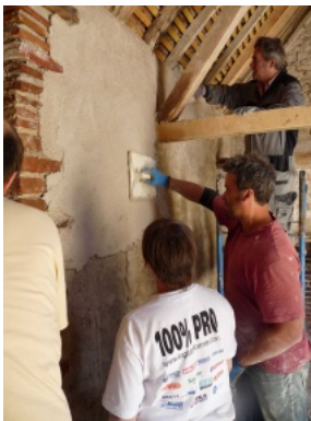
Pose de l'enduit de finition sur les murs intérieurs de la loge. Photo Claudie Plisson ©
